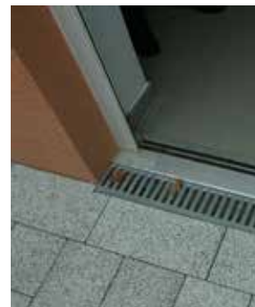
Schwellen vermindern oder beseitigen
